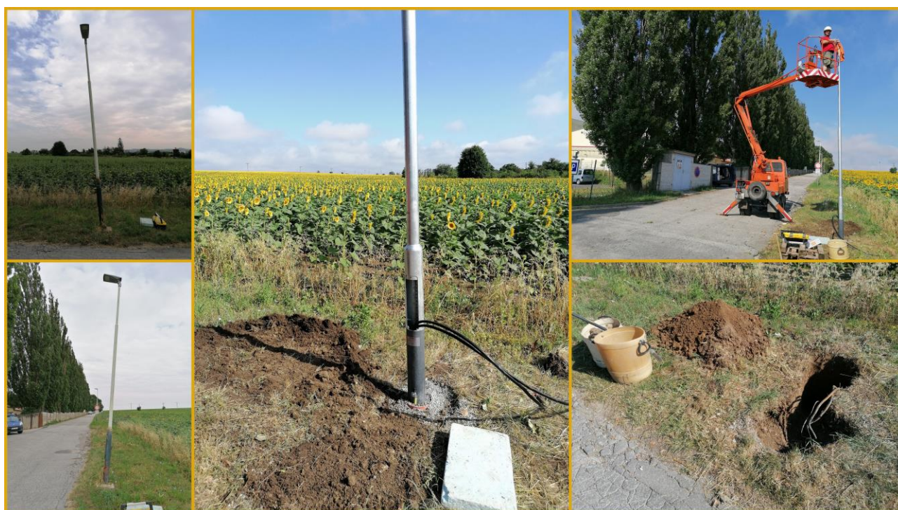
Za nemocnicí u vjezdu na parkoviště nemocnice. Zde proběhla výměna již několikrát nabouraného stožáru za nový, který se posunul dál od vozovky.
