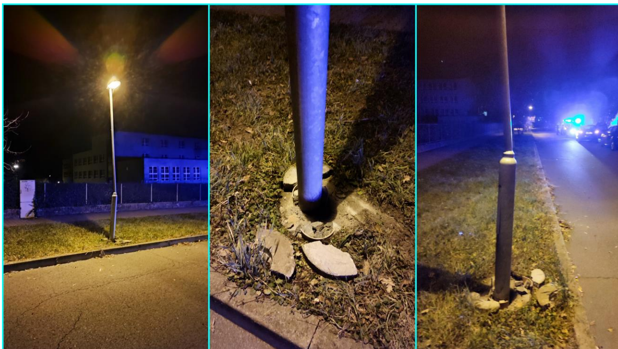
Ul. Újezd u školy. Svítidlo náraz přežilo, udělala se nová betonová patka pro stožár, vyměnil se stožár a proběhla oprava kabelů.
